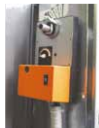
Автоматический привод управления вентиляционными
